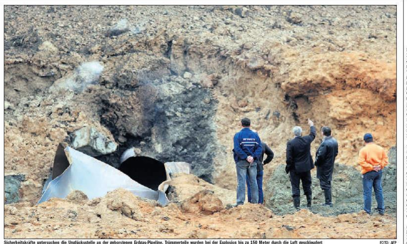
Sicherheitskräfte untersuchen die Unfallstelle an der geborstenen Erdgas-Pipeline. Trümmerteile wurden bei der Explosion bis zu 150 Meter durch die Luft geschleudert.
